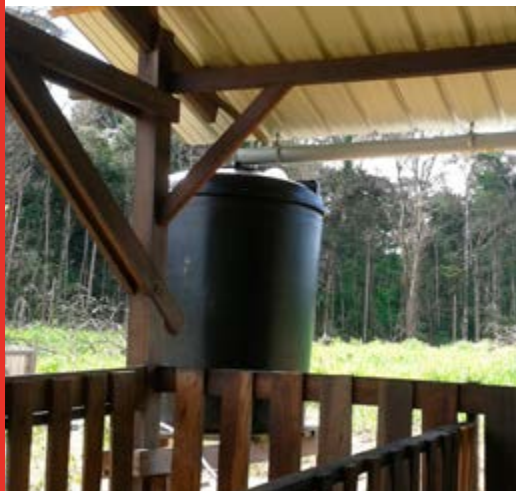
Citerne de récupération des eaux de pluies
